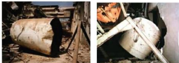
飛翔したタンクの前方部(左)と後方部
